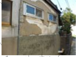
ブロック塀の損壊
