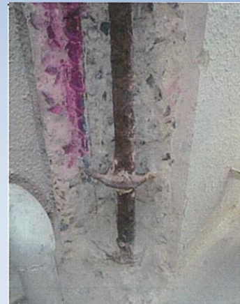
本館本棟柱の鉄筋の腐食
