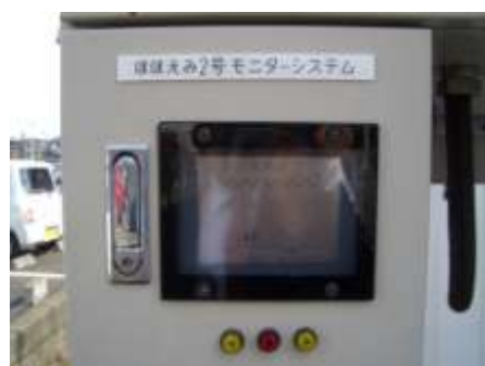
発電モニター
