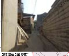
避難通路 ブロック倒壊の恐れあり
