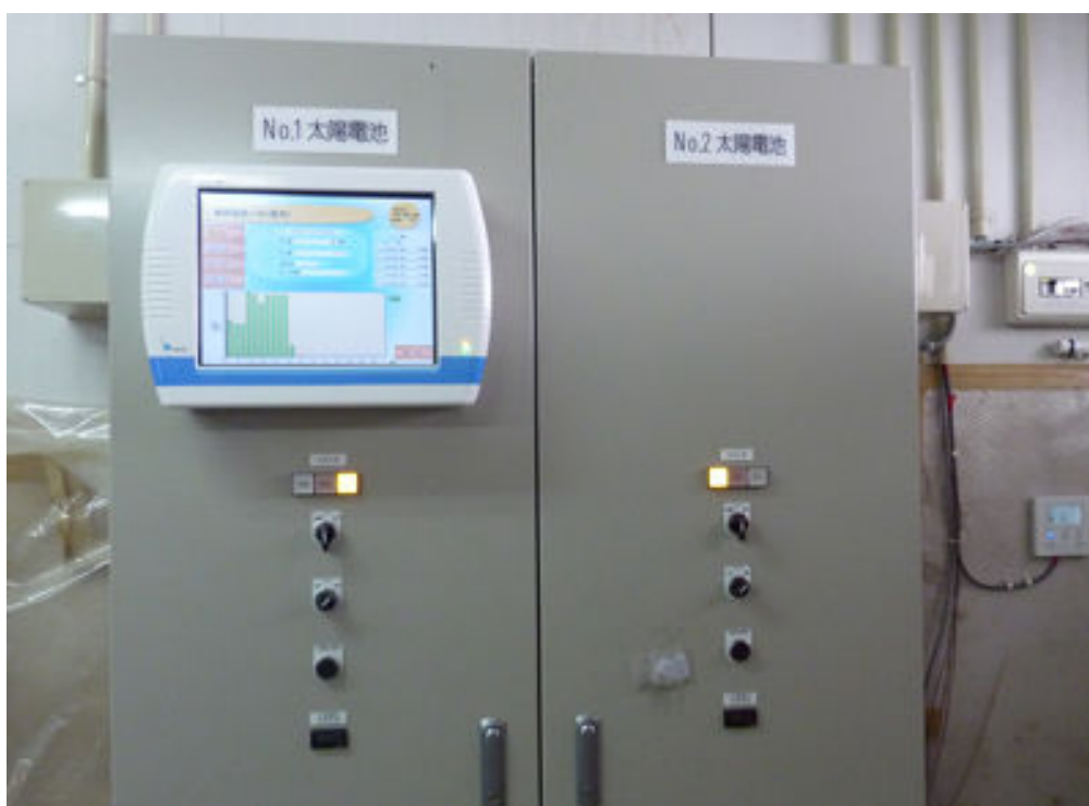
写真 14 電力量見える化モニター (町単費)
