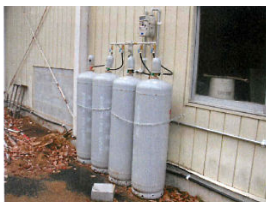
写真 10 燃料電池の燃料 (LP ガス)
