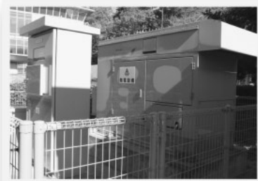
設置された非常用発電機
