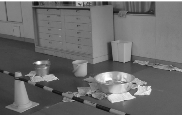
雨漏りの激しい小学校校舎
