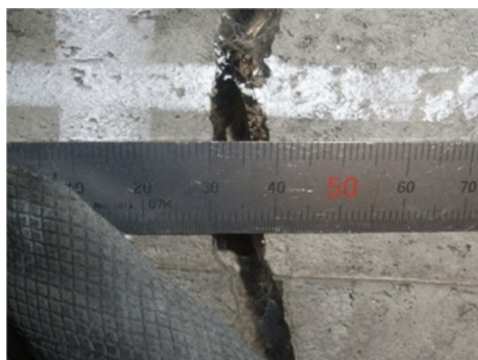
覆工（アーチ）のひび割れ
