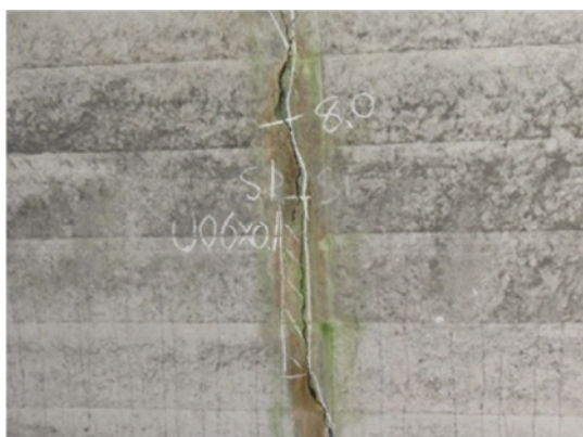
覆工（アーチ）のうき
