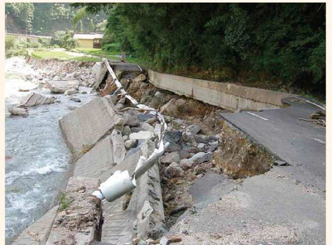
豪雨災害により崩れた町道魚切線
