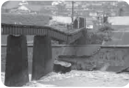
大雨により因原の八面では三江線の橋脚や堤防が流出
